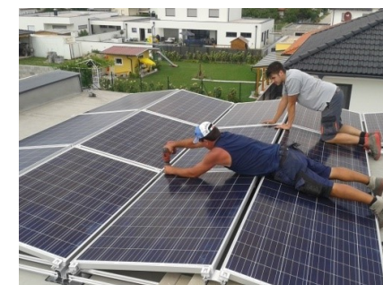
© J. Gansch | eigene PV-Anlage, eNu
